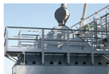
Sistema de carga de gravedad
